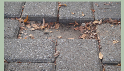
Sunken & uneven pavers
